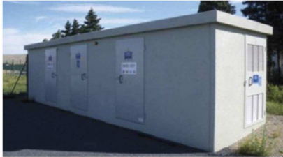
Poste de transformation
